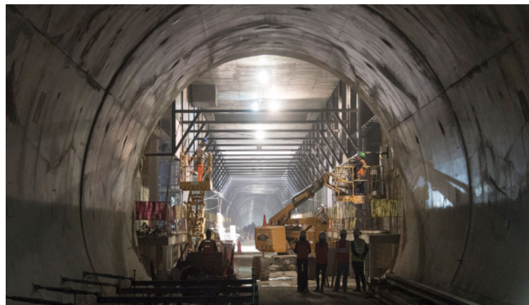
Se está construyendo un túnel y estación para una línea de metro que proporciona un sistema de transporte más seguro y sostenible en Lima, Perú.
